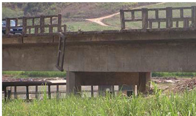
Figura 4 - Guarda corpo da ponte danificado
