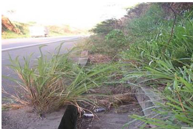
Figura 7 –Acostamento e canaleta de drenagem invadidos pela vegetação
