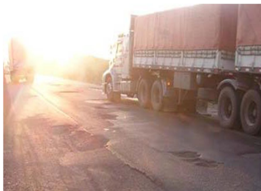
Figura 3 - Buracos na pista de rolamento
